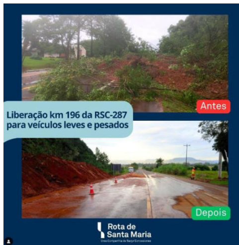
(obra finalizada, km 196, liberando totalmente a pista atingida por deslizamento de talude)
