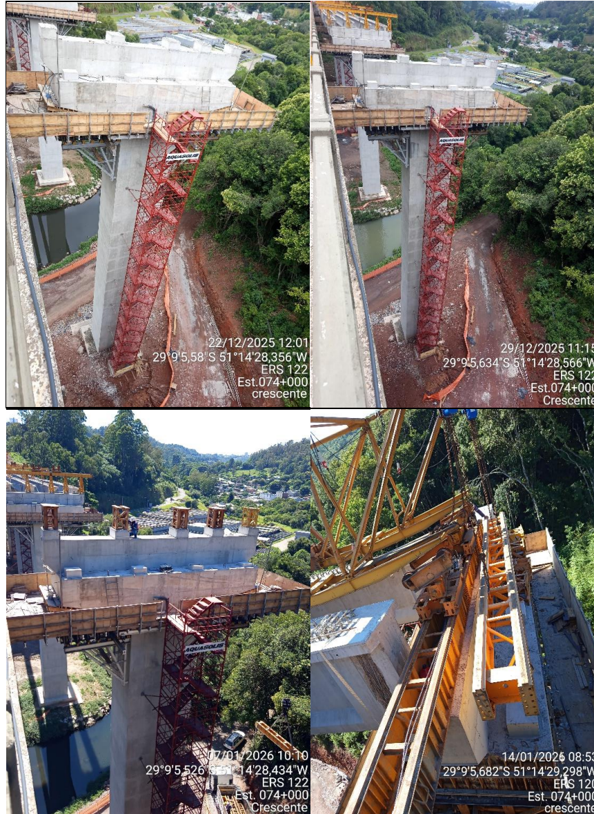
Foto 09 a Foto 12- O pilar e viga travessinha do apoio P03 apresentou desenvolvimento razoável da estrutura entre 19/12/2025 e 16/01/2026.
