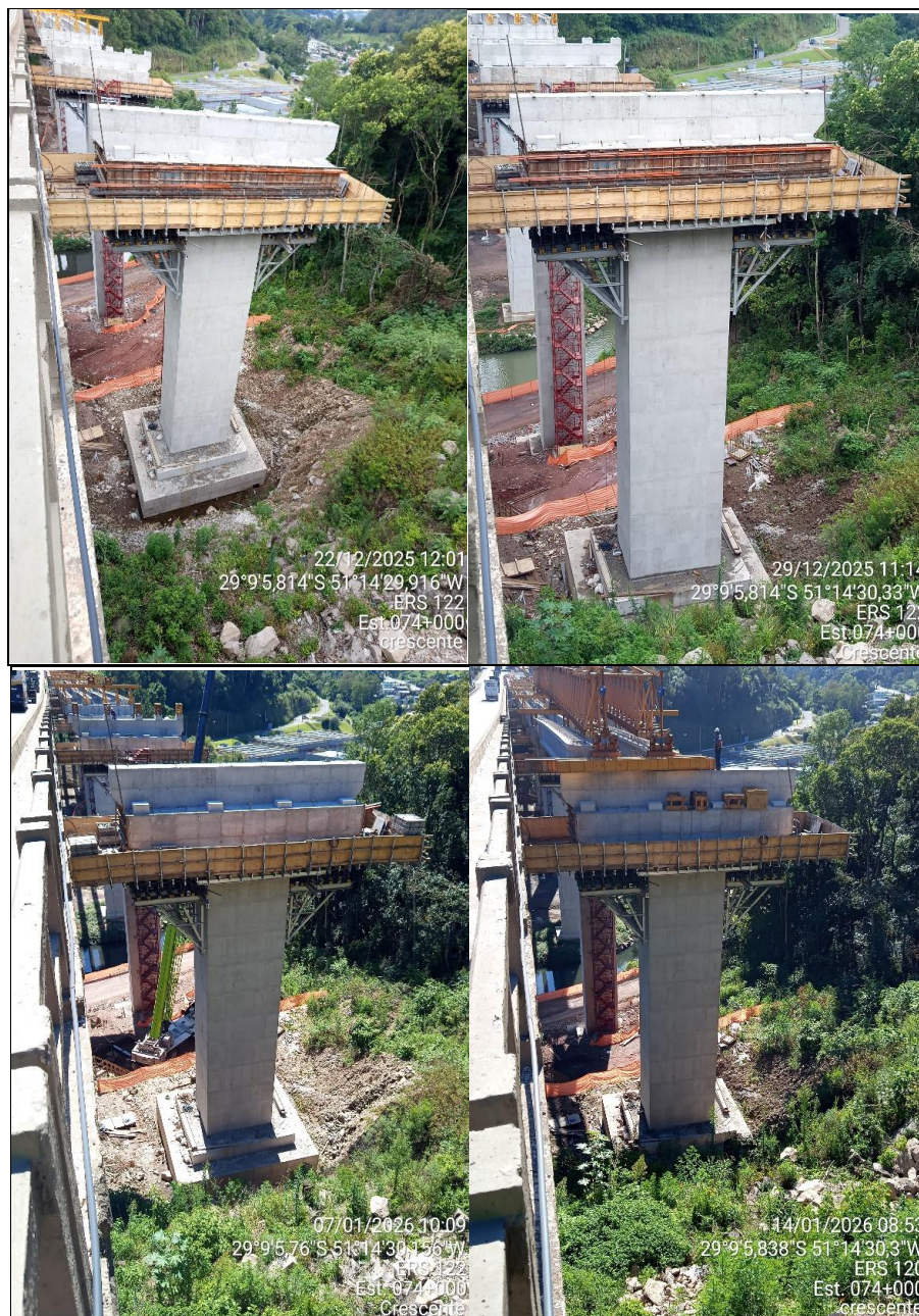
Foto 05 e Foto 08- O pilar e viga travessinha do apoio P02 apresentou desenvolvimento razoável da estrutura entre 19/12/2025 e 16/01/2026.
