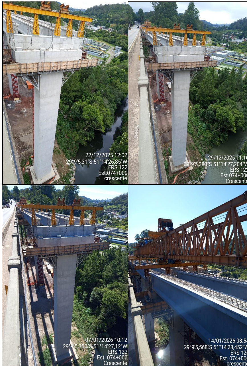
Foto 13 a Foto 16 – A estrutura do pilar P04 desenvolveu-se de forma razoável e foi acoplado os apoios da plataforma de lançamento das longarinas entre 19/12/2025 e 16/01/2026.
